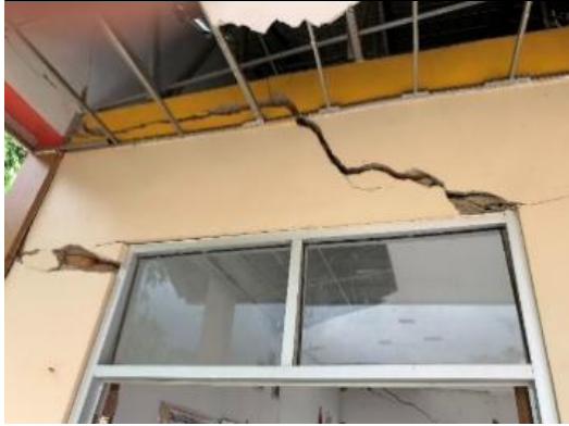
Gambar 5. Retakan Besar Pada Dinding SMKN 1 Cugenang
