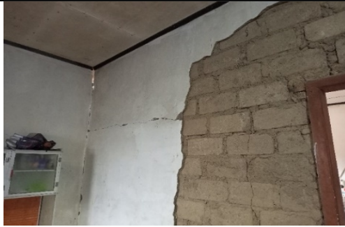
Gambar 3. Plester Dinding yang Terkelupas di Desa Benjot
